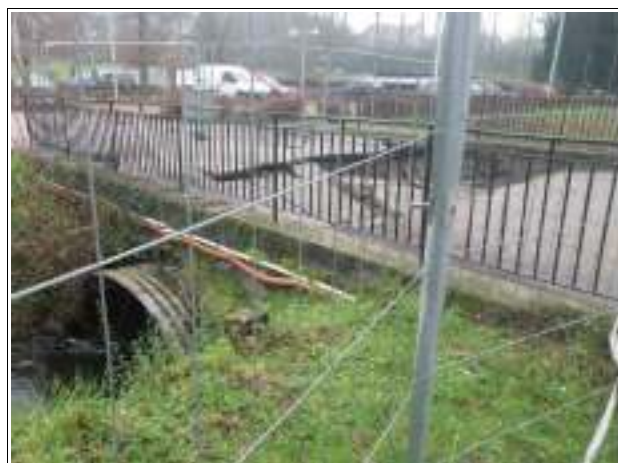
Vue de l'ouvrage de franchissement après effondrement
