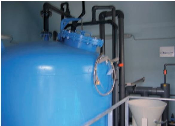
Filtre de la station de traitement.
